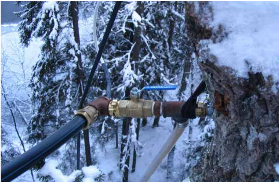
Keinotekoisien jääpuiston säätöventtiili ja lämmitys-kaapelin läpivienti
